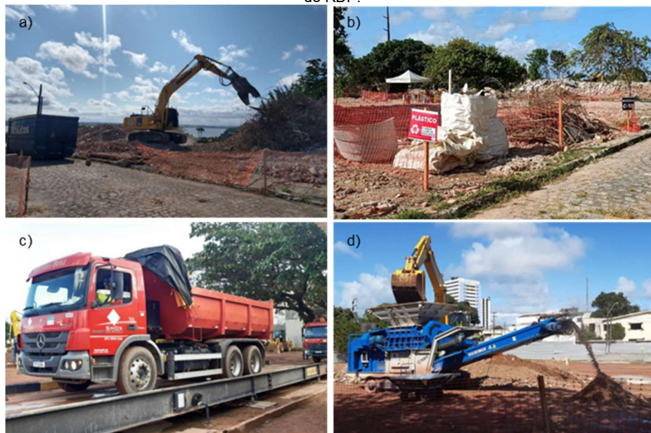
Figura 3: Procedimentos: (a) segregação mecanizada; (b) materiais do RD; (c) transporte do RD para cominuição primária; (d) geração de RDP.
