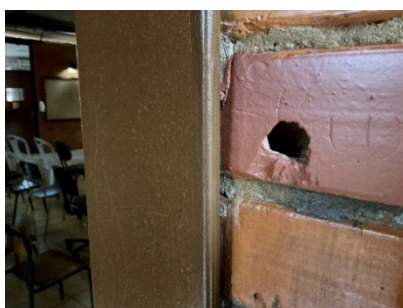
Figura 6 – Furo no revestimento em uma das paredes do Bloco D. Fonte: Elaborado pelo autor (2023).
