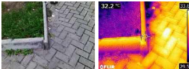
Figuras 06 e 07 - Fotografia e imagem termográfica de trecho de calçada na avenida Conde da Boa Vista, obtidas pela câmera FLIR TG165. Fonte: Ruskin Freitas, 2017.
