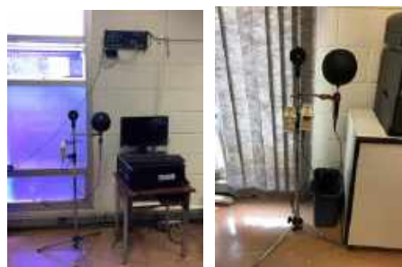
Figura 4- Sequência de fotos que destacam os equipamentos instalados nas salas, respectivamente P1 da secretaria de extensão e P1 e P2 da sala de Finanças. (Fonte: acervo pessoal)
