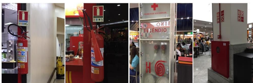
Figura 14 e 15 – Extintores praça 01 (direita); Extintor da praça de alimentação 02 (esquerda); Caixa de alarme da praça 01 e 02 (AUTORA, 2022).
