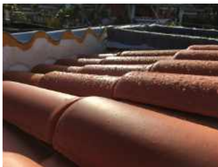
Figura 5: Condensação sobre a superfície das telhas cerâmicas
