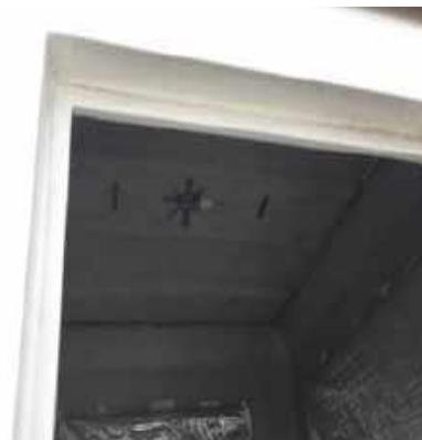
b) Sensor fixado no interior do MC.
