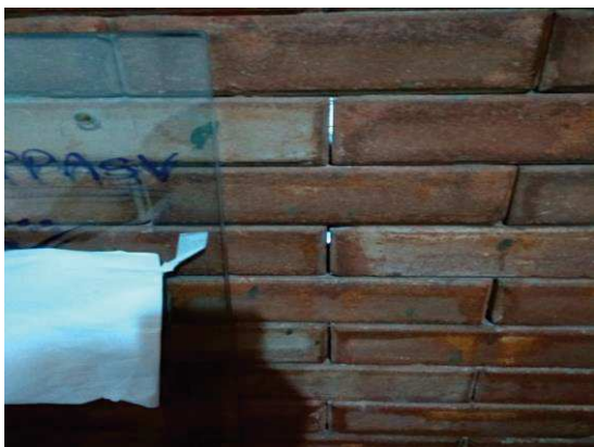
Figura 17 – Ausência de argamassa na junta vertical entre alguns tijolos.
