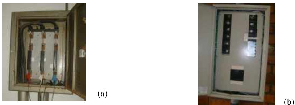
Figura 4 – Quadros elétricos de força; (a) quadro principal de distribuição de energia; (b) quadro terminal que alimenta dos condicionadores de ar
