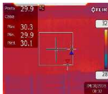
Figura 3 – Imagem térmica da superfície interna da parede da biblioteca.
