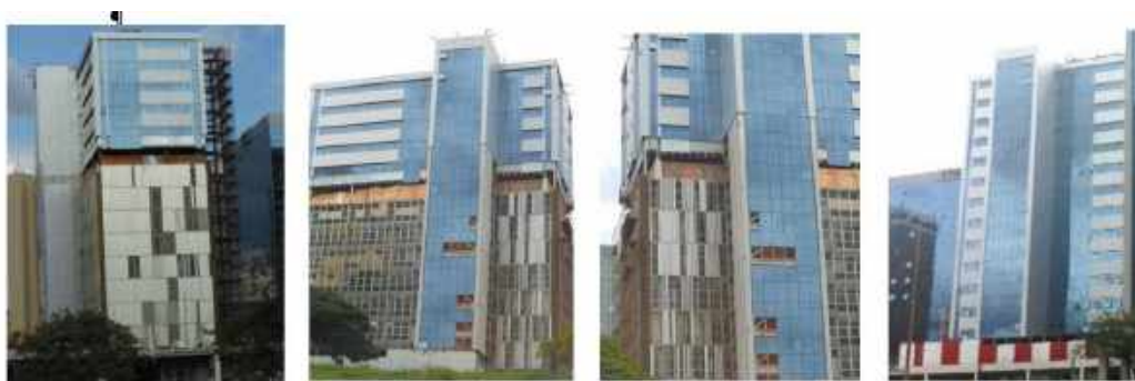
Figura 1 - Imagens da cronologia da intervenção na fachada de edifício localizado no Setor Bancário Sul: substituição dos brises por vidros reflexivos (fotos: Cláudia Amorim)
