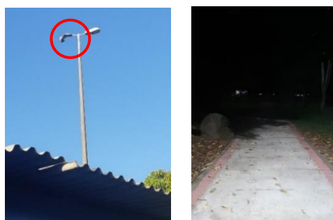
Figura – À esquerda, um poste de 12m com degradação da luminária, e à direita, local mal iluminado no campus.
