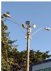
Figura 5 – Refletores em poste de 7m.
