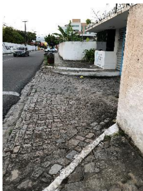
Figura 3 - Desnível na calçada (BARROS, 2018)
