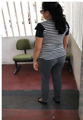
Figura 9 – Rampa sem sinalização prévia de alerta e piso escuro (BARROS, 2018)
