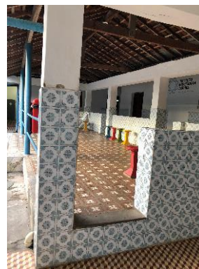
Figura 4 - Desnível na calçada (BARROS, 2018)
