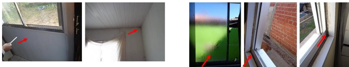
Figura 4 – À esquerda, condensação e bolor nas vedações em concreto-PVC e à direita no sistema em madeira. Fonte: Autores.
