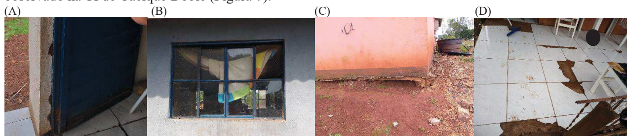
Figura 6 – Precárias condições de revestimento das construções de residências feitas pelo Programa Minha Casa Minha Vida em TIs do norte do Rio Grande do Sul; TI Cacique Doble (A, B e C), TI Carreteiro (D). Fonte: Autores, 2020.
