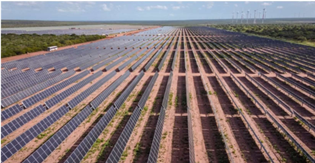
Figura 1 – Usina Fotovoltaica Serra do Mel 1 e 2. Fonte https://brasilenergia.com.br/energia/usinas-solares-serra-do-mel-1-e-2-comecam-a-produzir/ acessado em 19/06/2024
