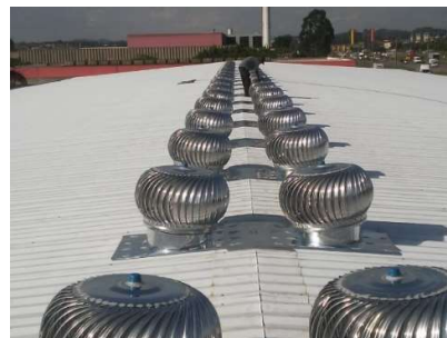
Figura 2: Exaustores instalados na cobertura
