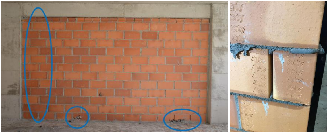
Imagem 1 – Problemas na execução de alvenarias
