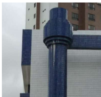
Figura 2 – Eflorescência na fachada da edificação
