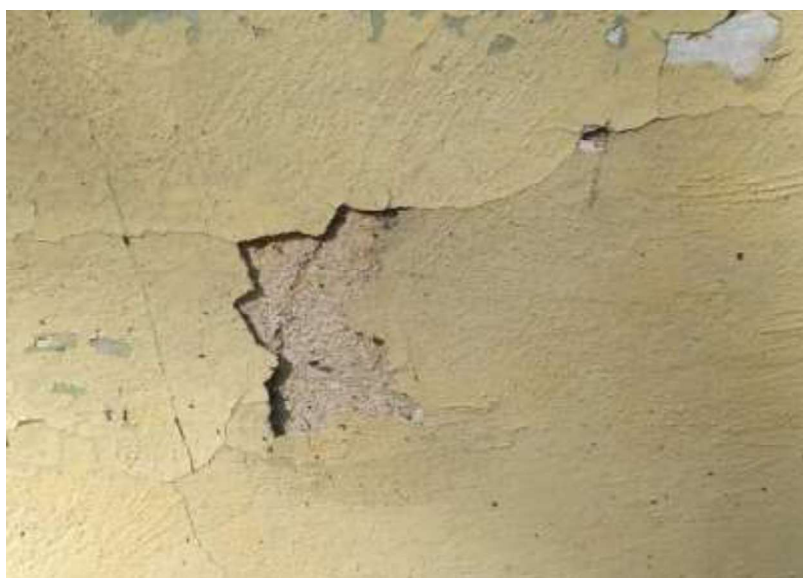
Figura 10 — Descolamento de pintura
