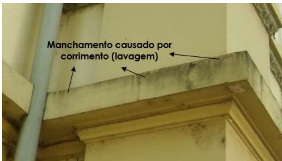
Figura 7 — Manchamento por sujeidade
