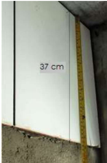
Figura 6 – Pré-condição inadequada –parte 1
