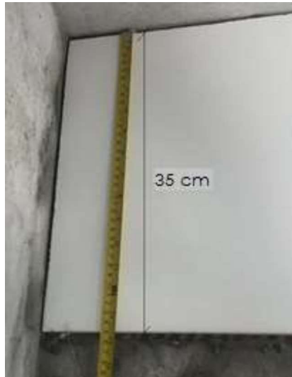
Figura 7 – Pré-condição inadequada –parte 2
