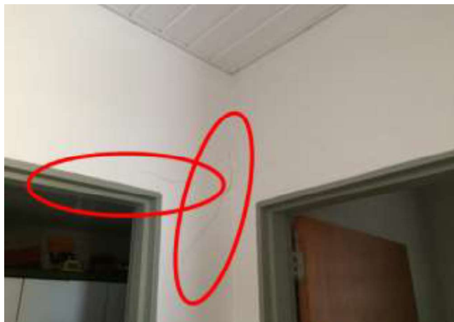
Figura 1 – Fissuras no EHIS B2
