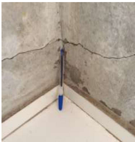
Figura 2 – Fissuras no EHIS B1
