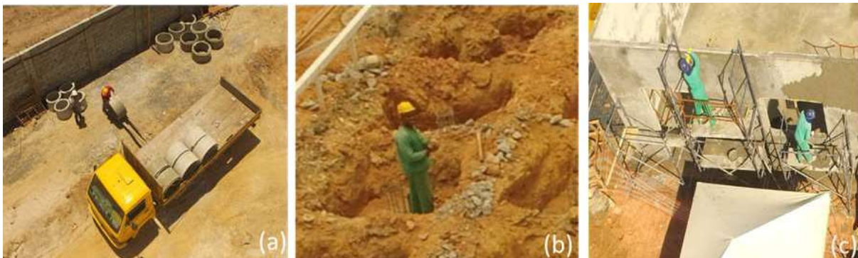
Figura 8 – Identificação de condições de trabalho insegura.
