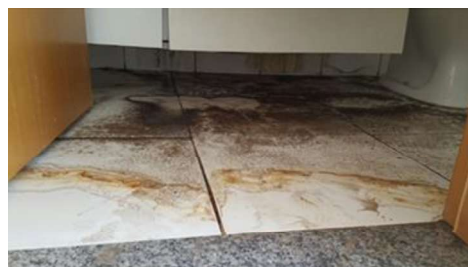
Figura 4 - Danos causados pelo vazamento do engate
