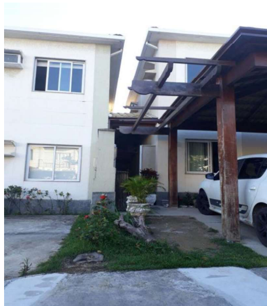
Figura 5 – Exemplo de cobertura instalada no afastamento frontal e lateral impedindo a ventilação
