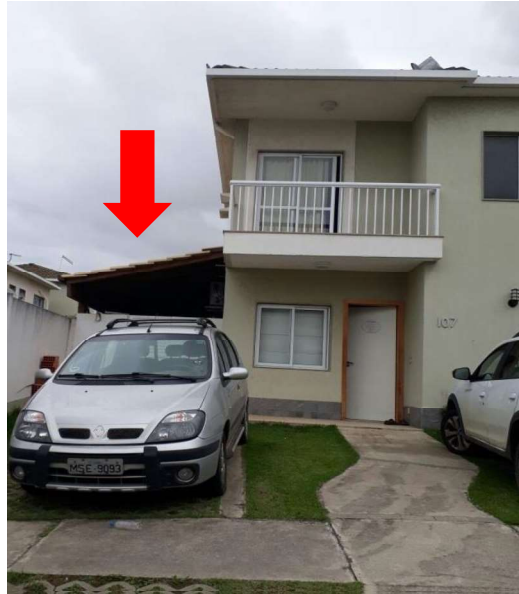
Figura 4 –Exemplo de alteração da fachada por acréscimo de cobertura lateral
