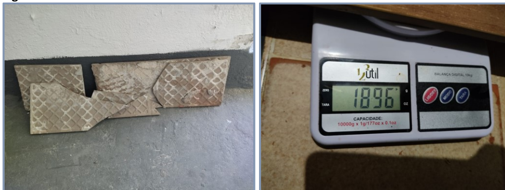
Figura 4: Placas com falha de aderência removida do Edifício B.
