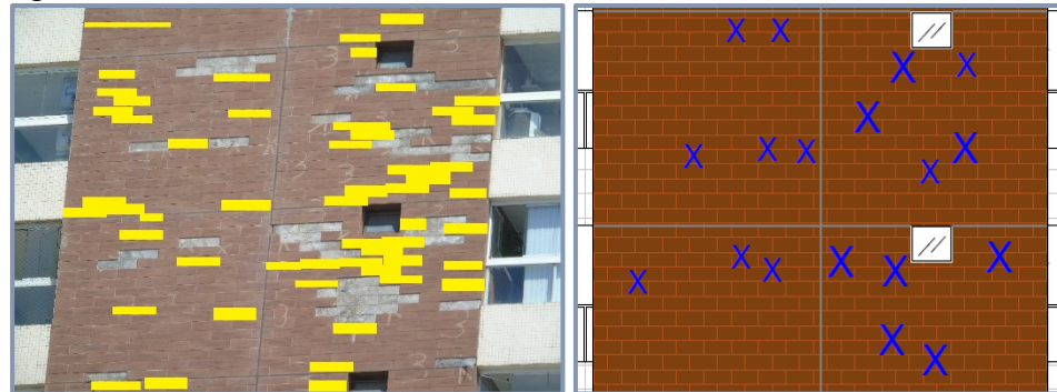
Figura 6: Som cavo no entorno das áreas sem revestimento.
