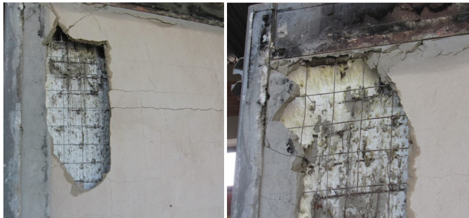
Figura 7: Degradação do EPS e deslocamento do revestimento
