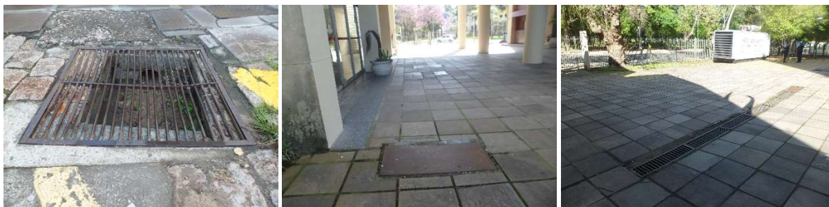
Figura 18: Grelha com aberturas e frestas largas (à esquerda) e caixas de inspeção e grelhas no fluxo principal de caminamento (ao centro e à direita)
