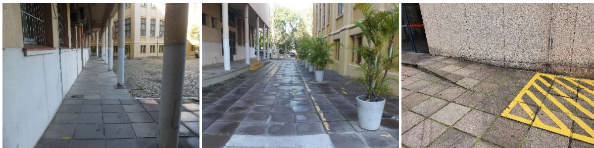
Figura 16: Ausência de proteção contra queda em corredor elevado (à esquerda); avanço de folhagens no corredor dedicado a pedestres na lateral do Anexo II da Reitoria (ao centro) e irregularidade no piso do patamar inferior da rampa de acesso ao Salão de Atos (à direita)
