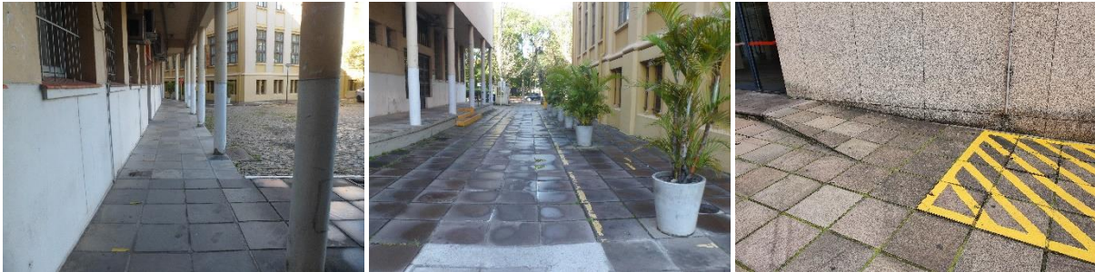
Figura 16: Ausência de proteção contra queda em corredor elevado (à esquerda); avanço de folhagens no corredor dedicado a pedestres na lateral do Anexo II da Reitoria (ao centro) e irregularidade no piso do patamar inferior da rampa de acesso ao Salão de Atos (à direita)
