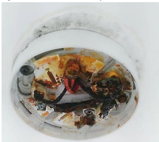
Figura 11: Detector de Fumaça Danificado
