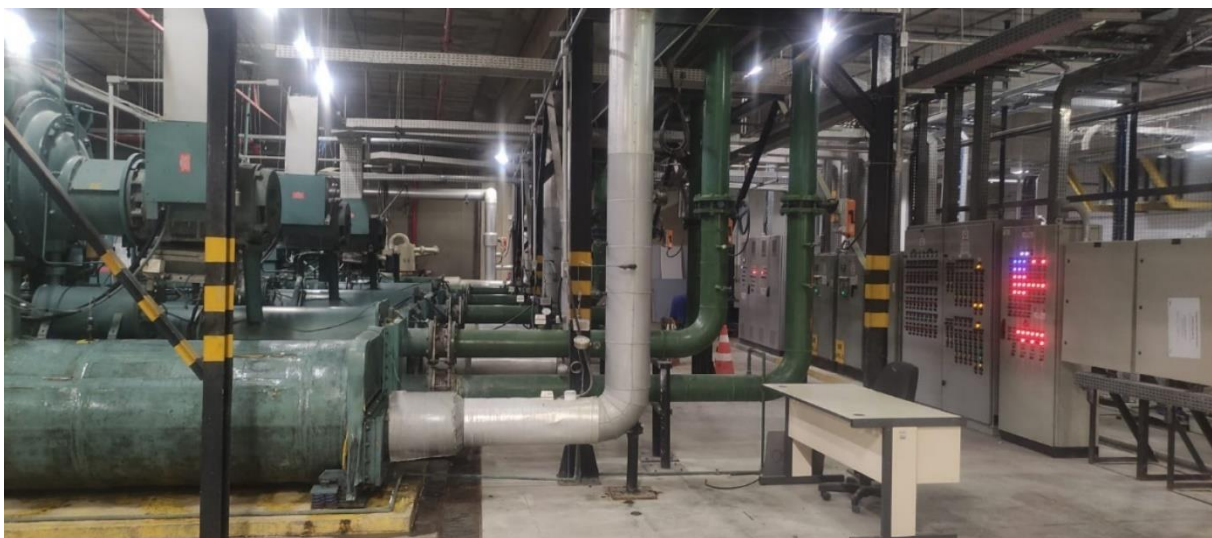
Figura 9: Central de Água Gelada
