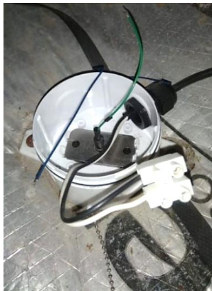
Figura 13: Sensor de Temperatura com Cabo Rompido
