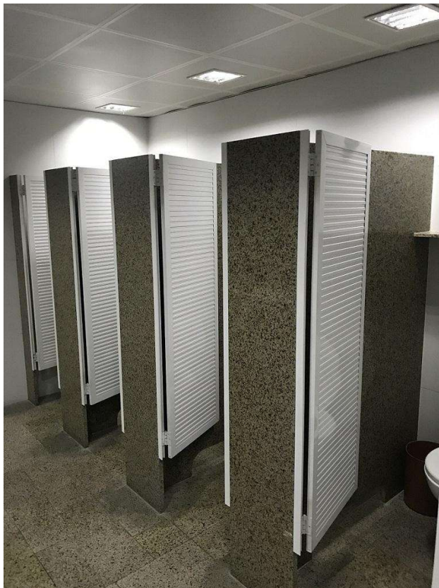
Figura 19: Novo forro branco e opaco usado nos banheiros atualmente
