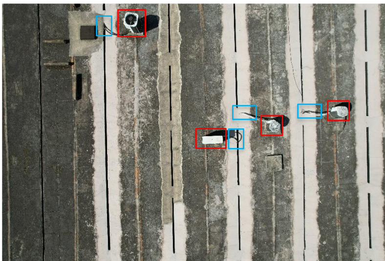
Figura 5: Vista de equipamentos e instalações prediais sobre a cobertura do Instituto Central de Ciências da Universidade de Brasília: fixação dos equipamentos na camada de proteção mecânica do sistema de impermeabilização, em vermelho, e tubulações passando por dentro das calhas metálicas, em azul.
