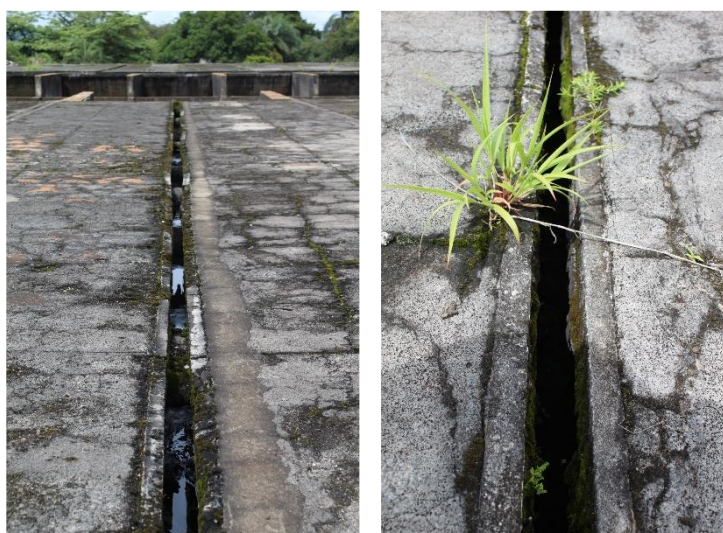
Figura 7: Proximidade das placas pré-moldadas dificulta ações de manutenção (à esquerda) e favorece a presença de vegetação invasiva na calha de alumínio (à direita).
