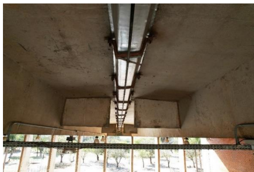
Figura 4: Vista interna dos painéis estruturais pré-moldados e calha de alumínio da cobertura do Instituto Central de Ciências da Universidade de Brasília.
