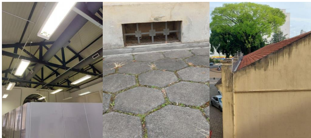
Figura 2: Sistema de ventilação mecânica do Edifício Anexo (à esquerda); fechamento do porão ventilado do Edifício Anexo (ao centro); e cobertura do Edifício Anexo (à direita)
