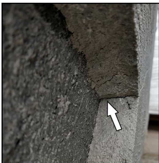
Figura 5: Vista da fissura na região deslocada
