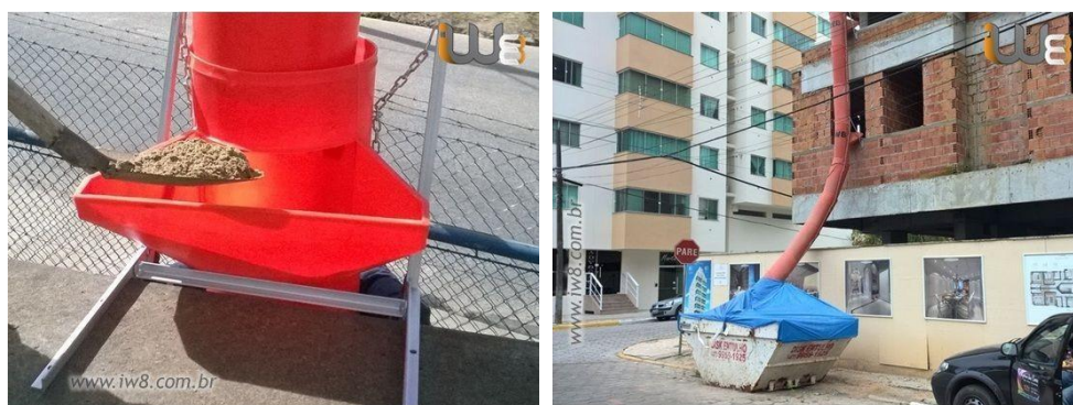
Figura 11: Duto de entulho.
