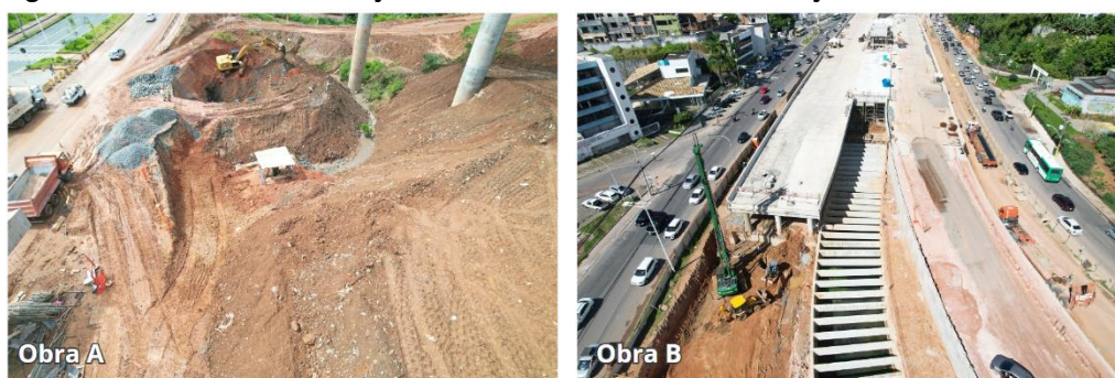
Figura 4: Isolamento e sinalização insuficiente das áreas de escavação
