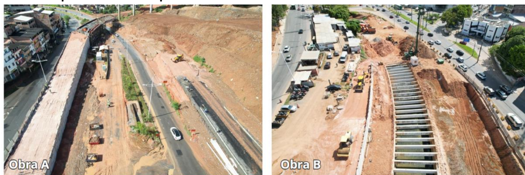
Figura 3: Exemplo da falta de tapumes ou barreiras ao longo do perímetro da construção de forma a impedir o acesso de pessoas estranhas.
