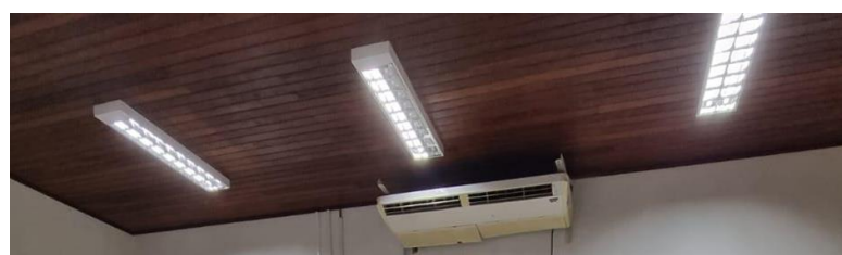
Figura 4: Luminárias da sala 112 com uma das lâmpadas queimadas
