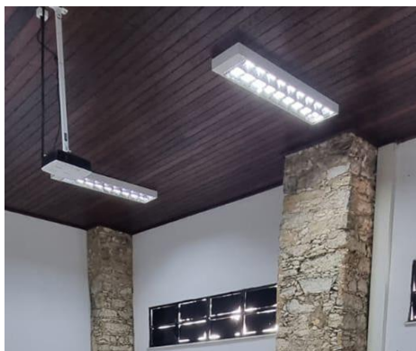
Figura 11: Fotografia das luminárias muito próximas das paredes na sala 202
