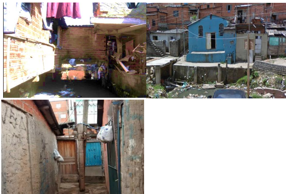
Figura 11: Adaptações implementadas pelos próprios moradores para evitar a entrada das águas de inundação.
