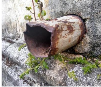
Figura 19 - Vista tubulação hidráulica
