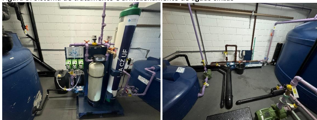
Figura 3: Sistema de tratamento e armazenamento de águas cinzas
