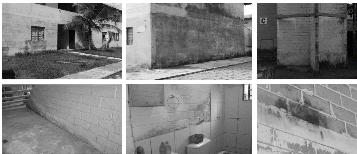
Figura 3: Conjunto de manifestações patológicas encontradas no residencial
