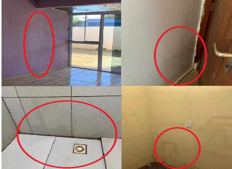
Figura 3: Infiltração por capilaridade
