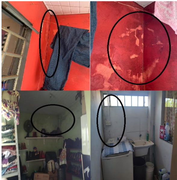
Figura 4: Infiltração por obras
