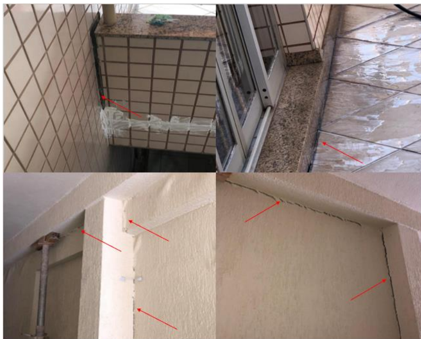
Figura 9 - Evidências do recalque diferencial em direção a obra.
