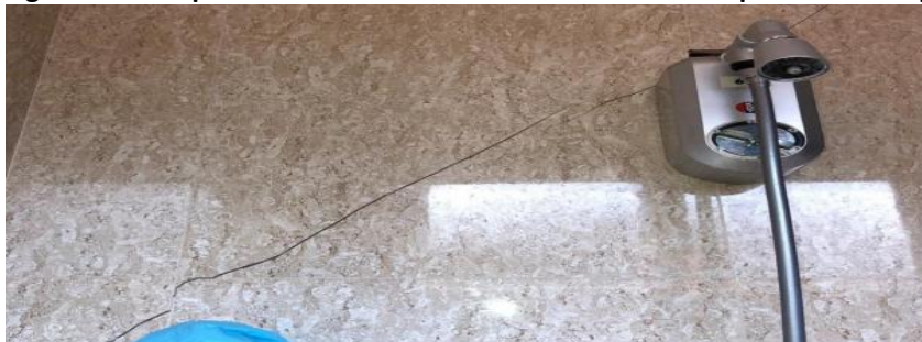
Figura 7 - Vista parcial interna da alvenaria do banheiro do apartamento superior.
