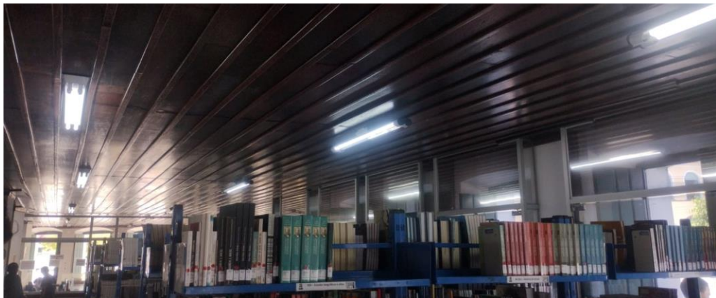
Figura 3: Foto do sistema de iluminação da BICAL/UFS.
