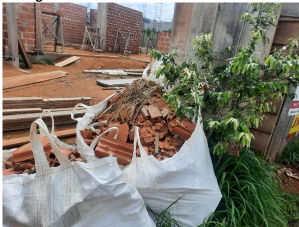
Figura 7: resíduos classe A acondicionados
