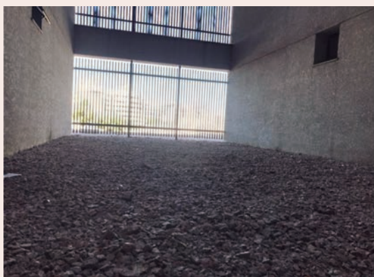
Figura 4. Tanque de brita para filtragem da água das coberturas das torres do condomínio: edifício W.
