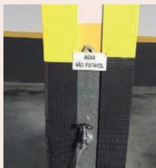
Figura 6. Torneira de água não potável identificada: edifício G.
