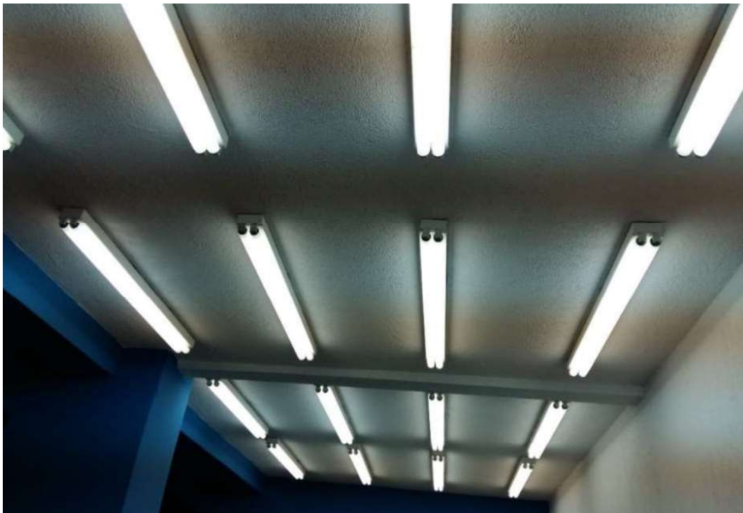
Fuente: luminarias encendidas de gradas, edificio CII Emilio Beltranena Matheu.
