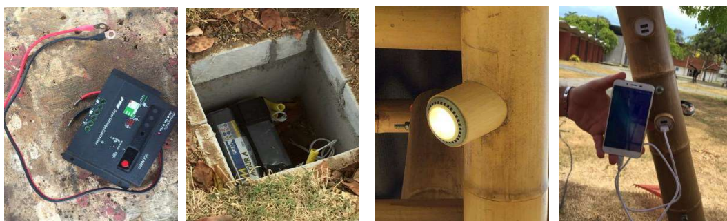
Figura 7. Instalação da bateria e controlador de carga e detalhe das instalações elétricas
