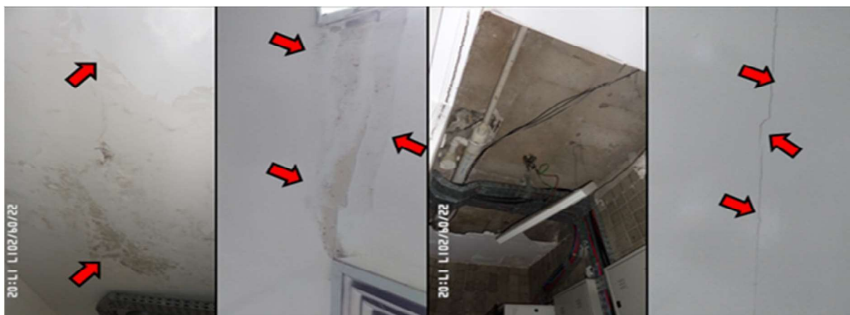
Figura 6. Problemas em teto com forro de gesso.
