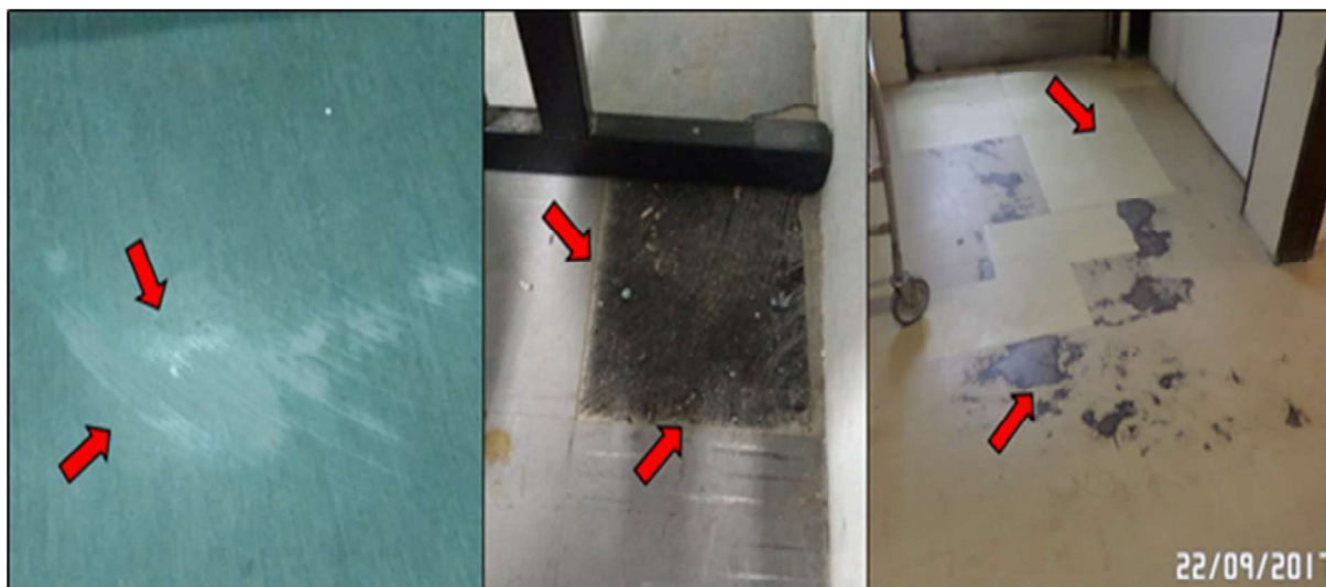
Figura 4. Problemas em piso vinílico.
