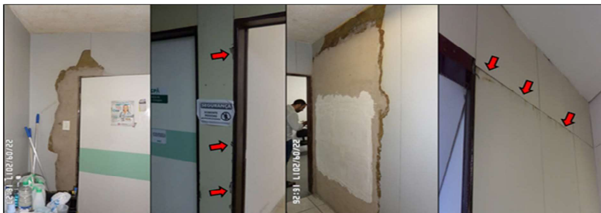
Figura 7. Problemas em paredes com acabamento em fórmica.
