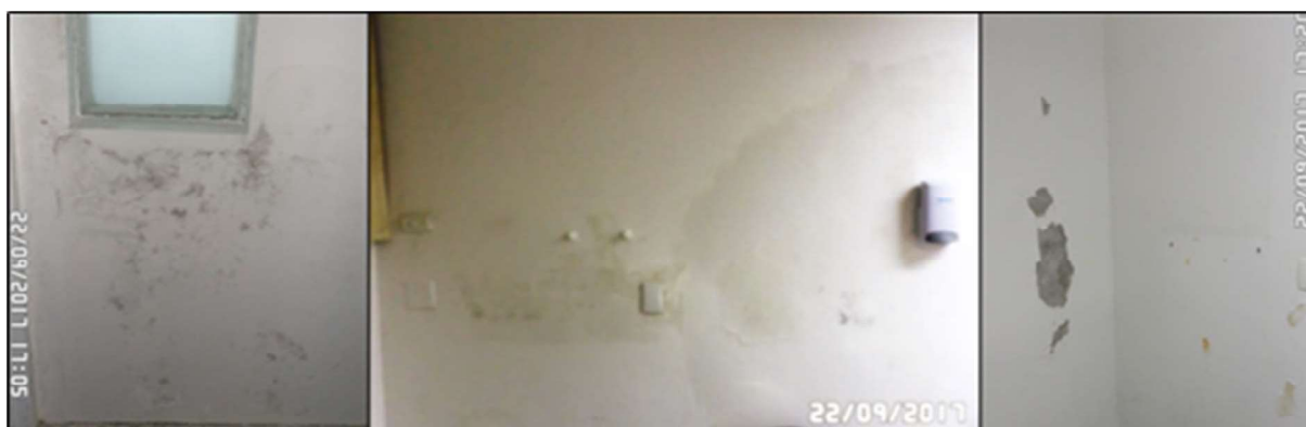
Figura 8. Problemas de umidade e destacamento em paredes com acabamento em pintura.
