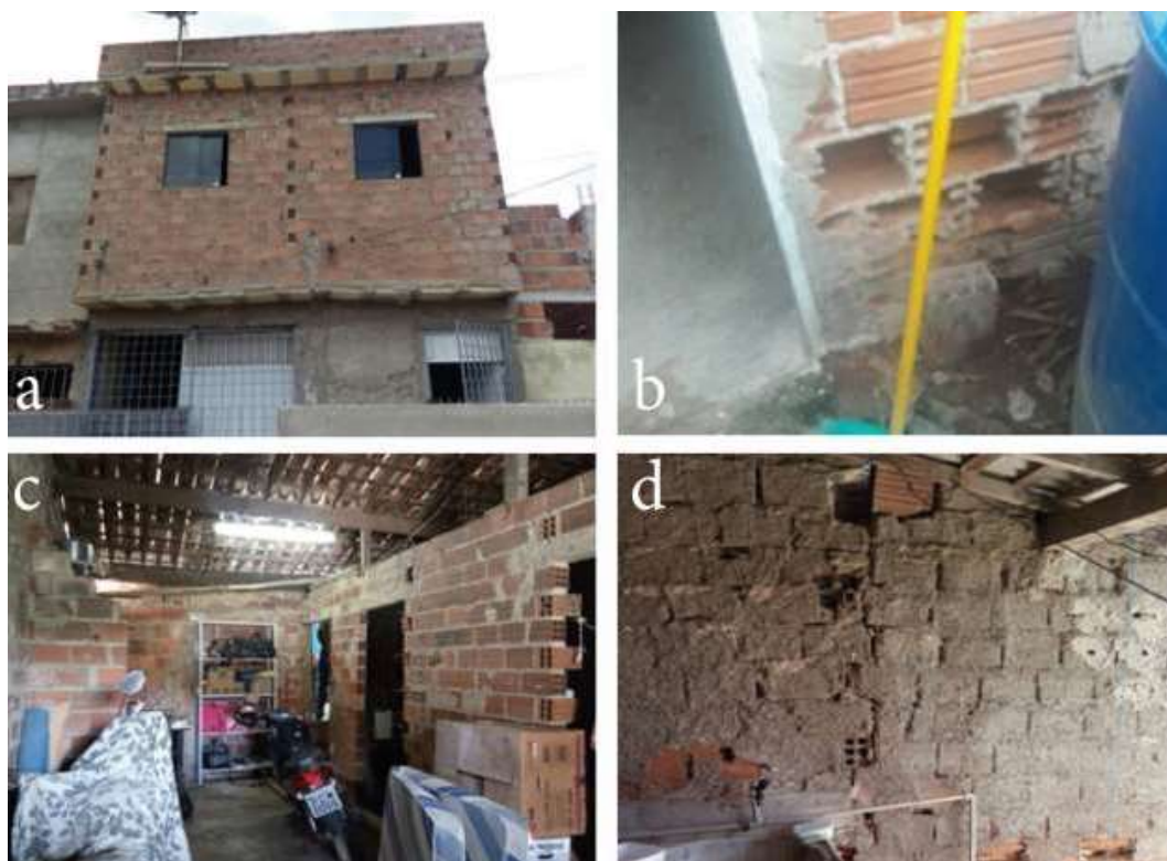
Figura 40. Trincas e problemas estruturais.
