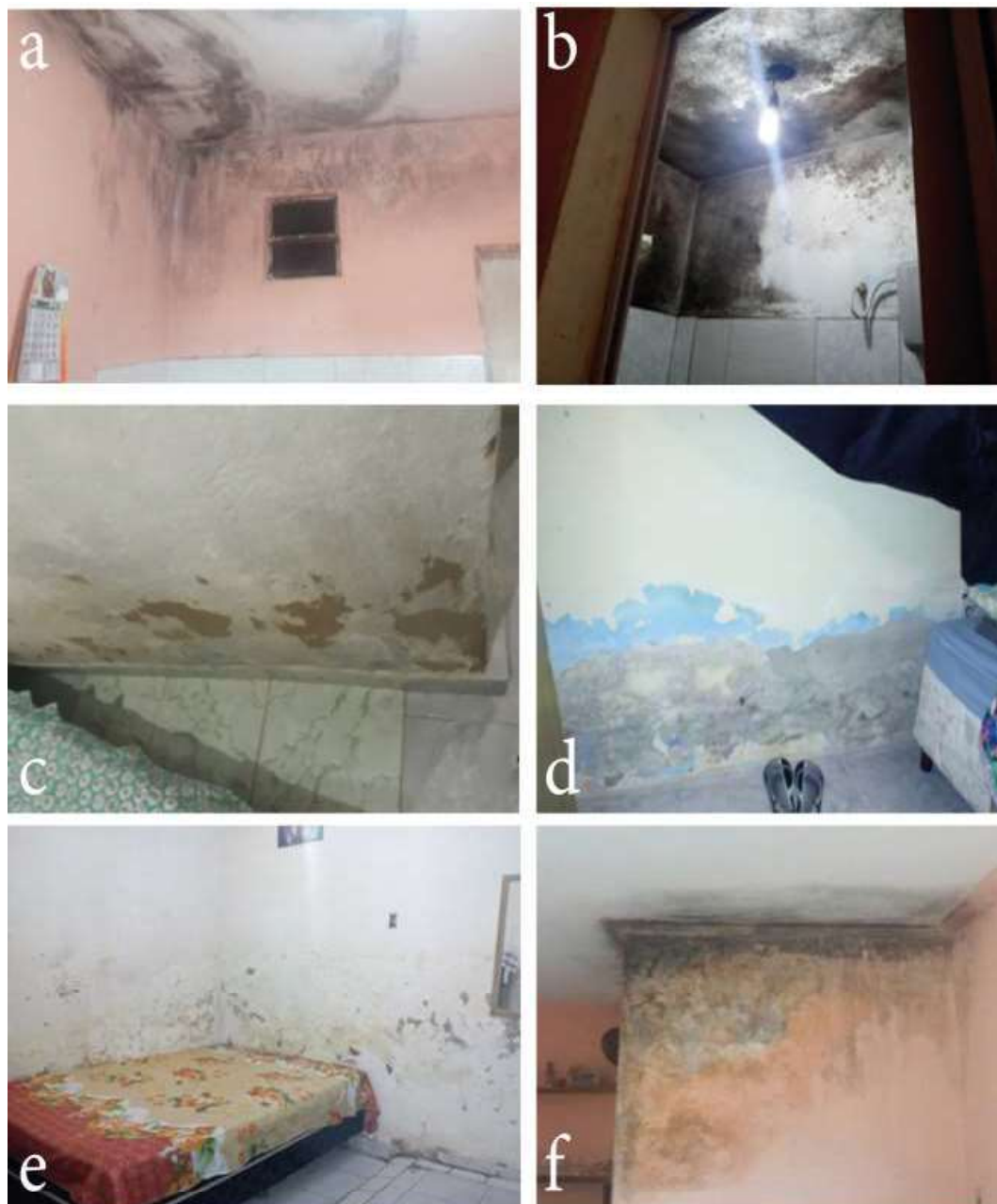
Figura 38. Infiltração e umidade.
